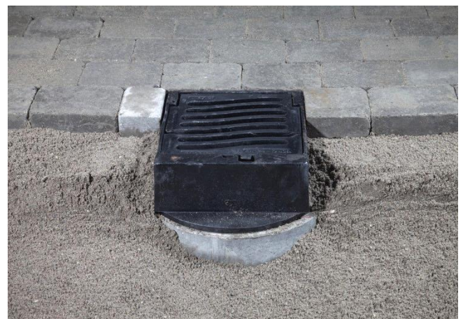
Gruset stemples og rettes af. Belægningsstenene skæres til og lægges. Et plant og flot resultat.
