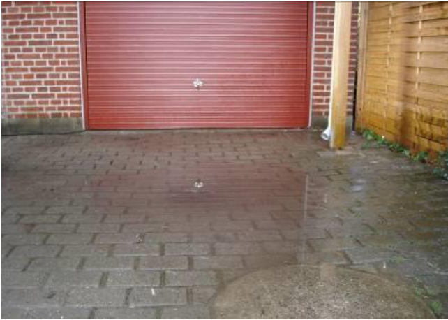
FØR – irriterende vandpytter foran og i garagen.
