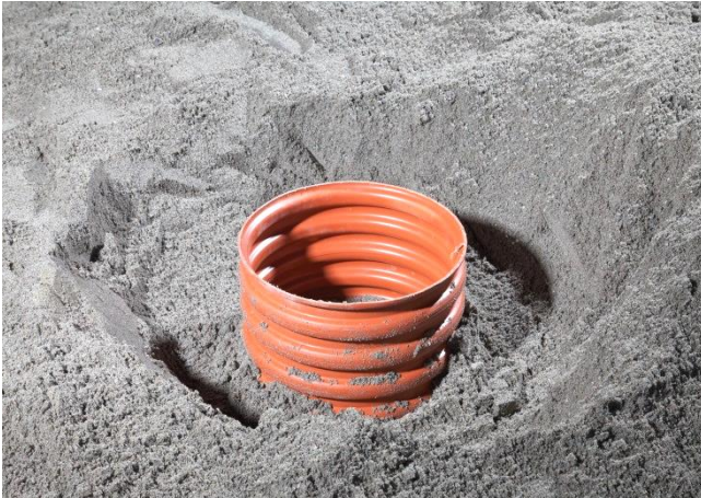
Ø315 PVC opføringsrør.
